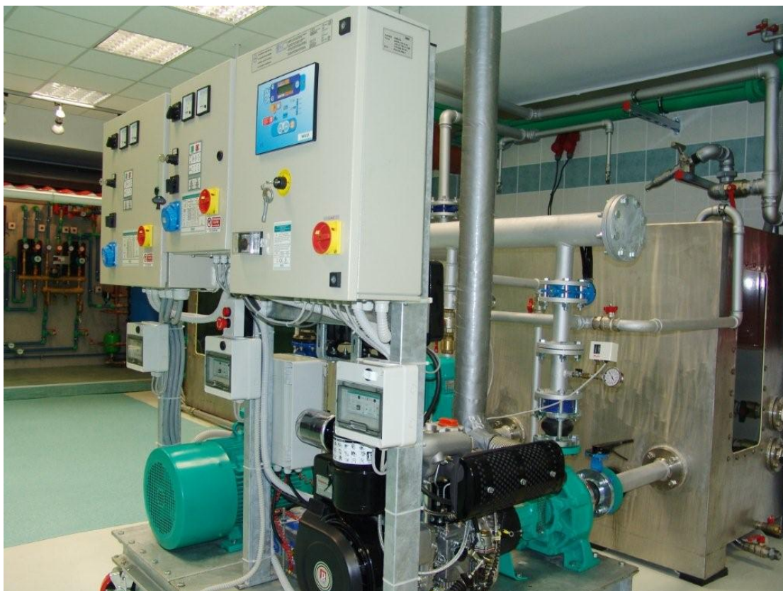
Σχήμα 5.2. Εγκατεστημένο πυροσβεστικό συγκρότημα
