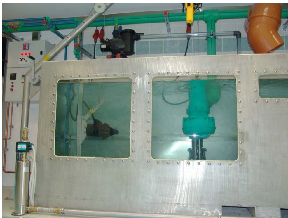
Σχήμα 5.5. Τμήμα αντλιών & αναδεντήρα λυμάτων (δεξαμενή)
