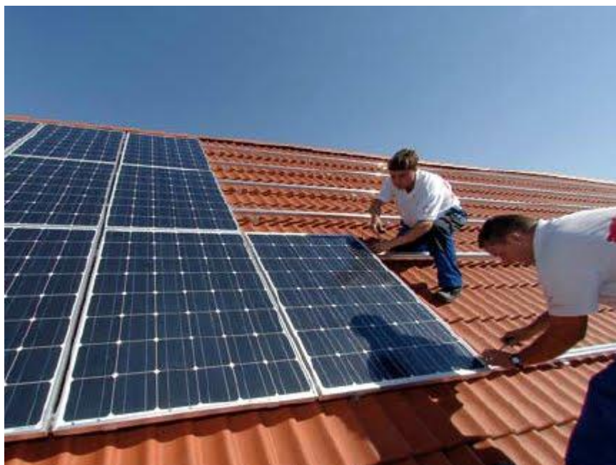
Σχήμα 36:φωτοβολταικά πλαίσια σε στέγη
