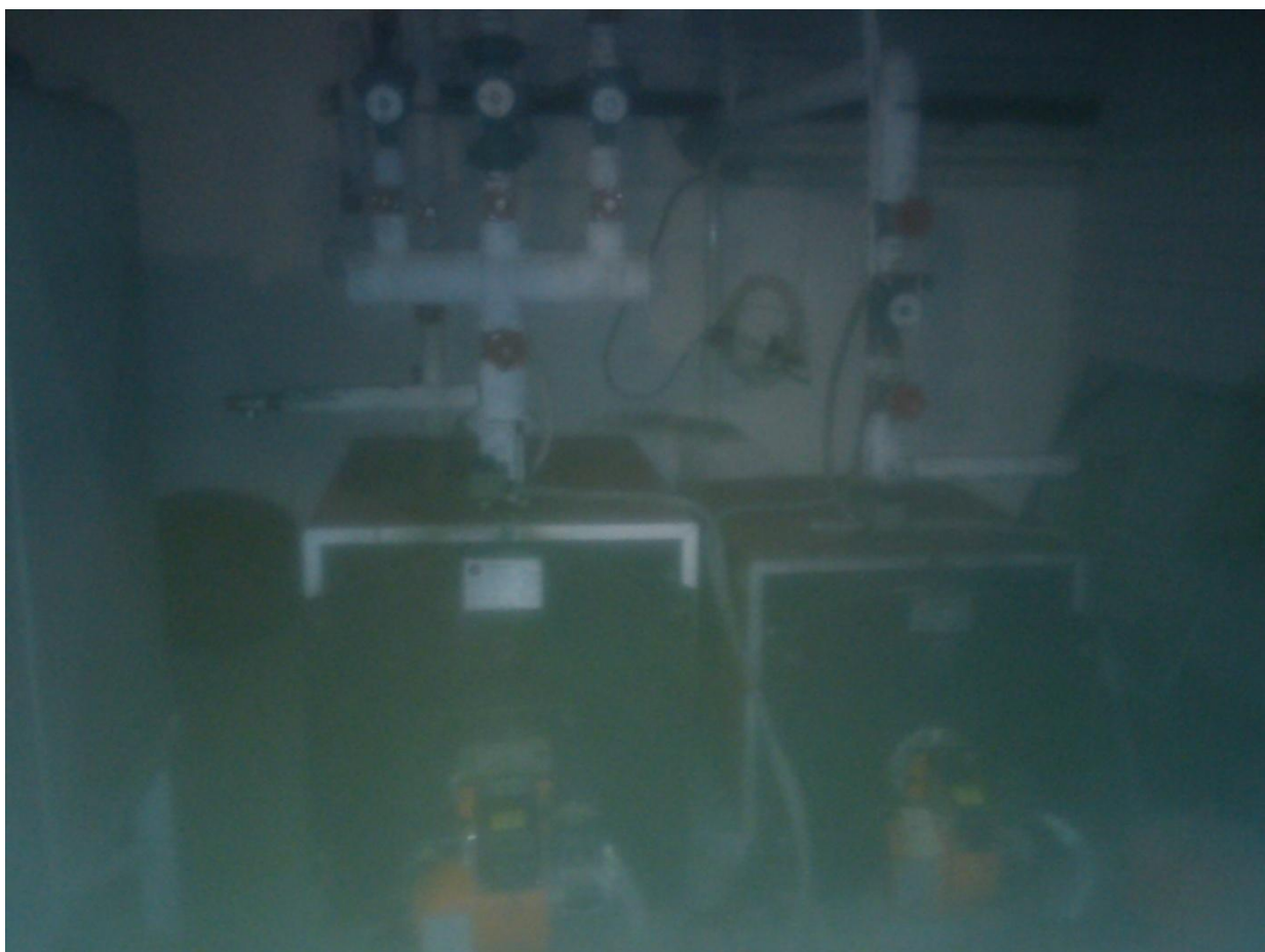
Σχήμα 28: λέβητας κλειστού γυμναστηρίου
