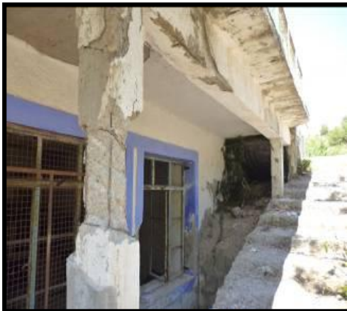
Σχήμα 6.15: Δοκοί και υποστυλώματα εξώστη – σημαντικές βλάβες
