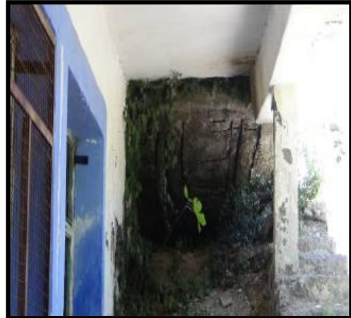
Σχήμα 6.14: Κάτω παρειά εξωτερικής σκάλας – απώλεια επικάλυψης - διάβρωση οπλισμών
