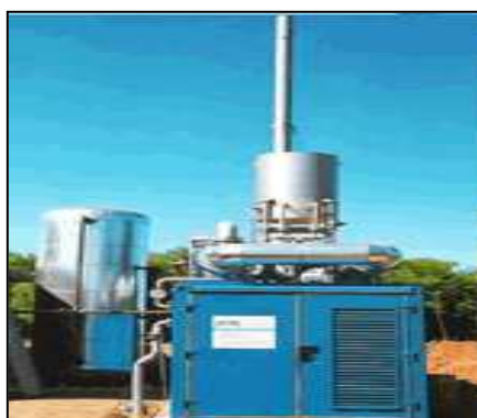
Σχήμα 4.6 Μονάδα παραγωγής 250kW ηλεκτρικής ενέργειας και 100kW θερμικής ενέργειας με την καύση βιοαερίου ( www.biofuels.gr )
