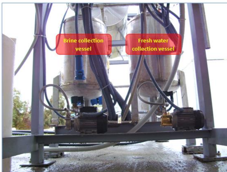
Εικόνα 5-11: Φωτογραφίες από τον εγκατεστημένο εξατμιστήρα
