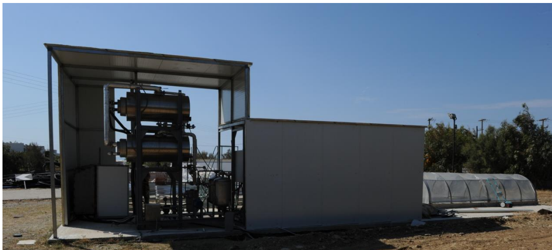
Εικόνα 5-32: Απόψεις από την εγκατεστημένη υποδομή στέγασης του πιλοτικού
