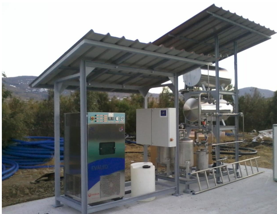
Εικόνα 5-29: Αρχική άποψη του εγκατεστημένου πιλοτικού συστήματος
