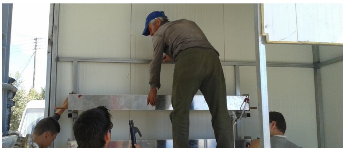
Εικόνα 5-36: Εγκατάσταση ηλιακού θερμαντήρα, κλάδος ανακυκλοφορίας (πάνω) και κλάδος τροφοδοσίας της άλμης (κάτω)
