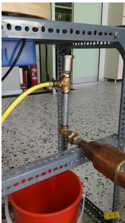
Σχήμα 4.6: Αυτόματο εξαεριστικό για την απομάκρυνση τυχόν αέρα ή ατμού στην έξοδο θερμού νερού του θερμαινόμενου κυλινδρικού αγωγού στο "αριστερό" άκρο. Διακρίνεται και η αποχέτευση του θερμού νερού, μέσω του κίτρινου ελαστικού αγωγού.
