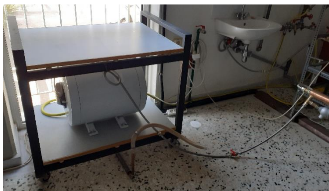
Σχήμα 4.11: Μικρός ηλεκτρικός θερμοσίφωνας για τη θέρμανση του εναλλάκτη ομοροής (διακρίνεται στα δεξιά) για τη μικρορύθμιση της θερμοκρασίας θερμού νερού.
