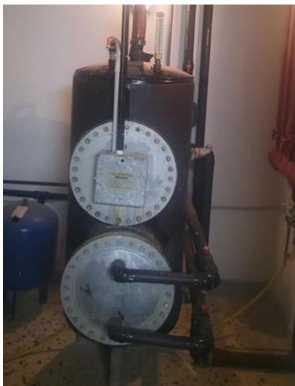
Σχήμα 4.7: Λέβητας προετοιμασίας θερμού νερού για τις ανάγκες της πειραματικής εργασίας
