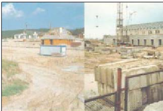
Εικόνα 1.40: Αντιπροσωπευτική εικόνα της εν λόγω κατηγορίας με παραδείγματα σπιτιών και άλλων τεχνικών έργων υπό κατασκευή από τη Σλοβακία (CLC manual).
