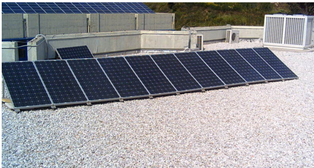
Εικόνα 1.2 : Φωτοβολταϊκή γεννήτρια εργαστηριακού μικροδικτύου
