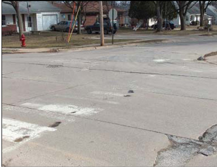
Εικόνα 1-9: Κακή κατάσταση διαγράμμισης
