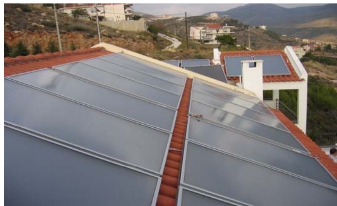
Εικόνα 3.10 Στέγη με ηλιακό σύστημα combi στην Αττική(πηγή: ΚΑΠΕ)
