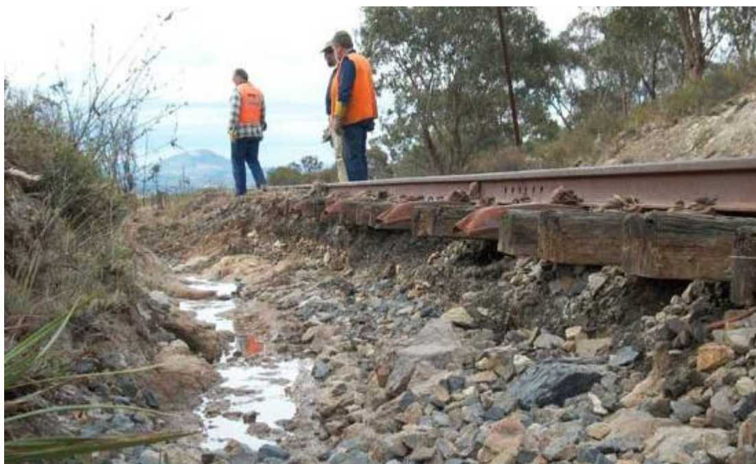
Εικόνα 3. Πλευρική απώλεια έρματος και μερική υποσκαφή λόγω διάβρωσης από νερά επιφανειακής απορροής
