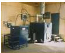
Μικρές ηλεκτροπαραγωγικές μονάδες
