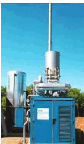
Εικόνα 19. Μονάδα παραγωγής 250kW ηλεκτρικής ενέργειας και 100kW θερμικής ενέργειας με την καύση βιοαερίου
