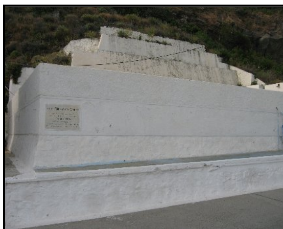
Εικόνα 5.4: Δεξαμενή αποθήκευσης νερού στο λιμάνι της Νισύρου.
