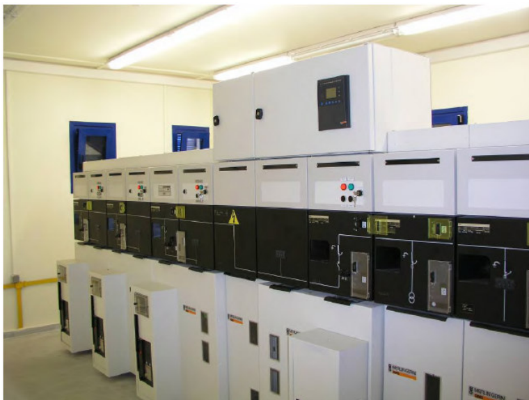
Τοπικός υποσταθμός Μ.Τ. 0,4/15 kV
