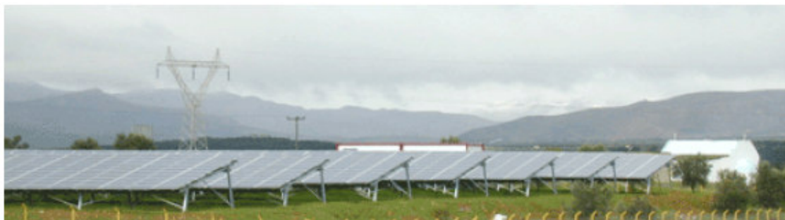
Ηλιακός σταθμός ηλεκτροπαραγωγής στην Κρήτη
