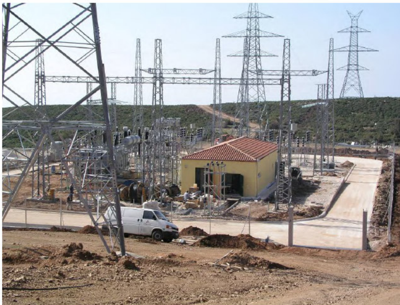
Τυπικός υποσταθμός Υ.Τ. 50.000 KVA, 150/21 kV
