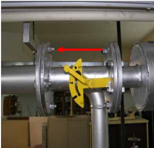
Εικόνα 7.2. Βάνα ελέγχου της πίεσως εξόδου των καυσαερίων.
