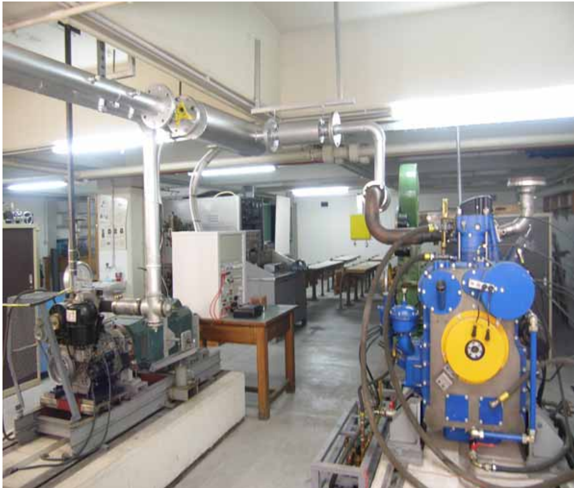
Εικόνα 7.1. Το Σύστημα Εξαγωγής Καυσαερίων εγκατεστημένο στην οροφή του εργαστηρίου.
