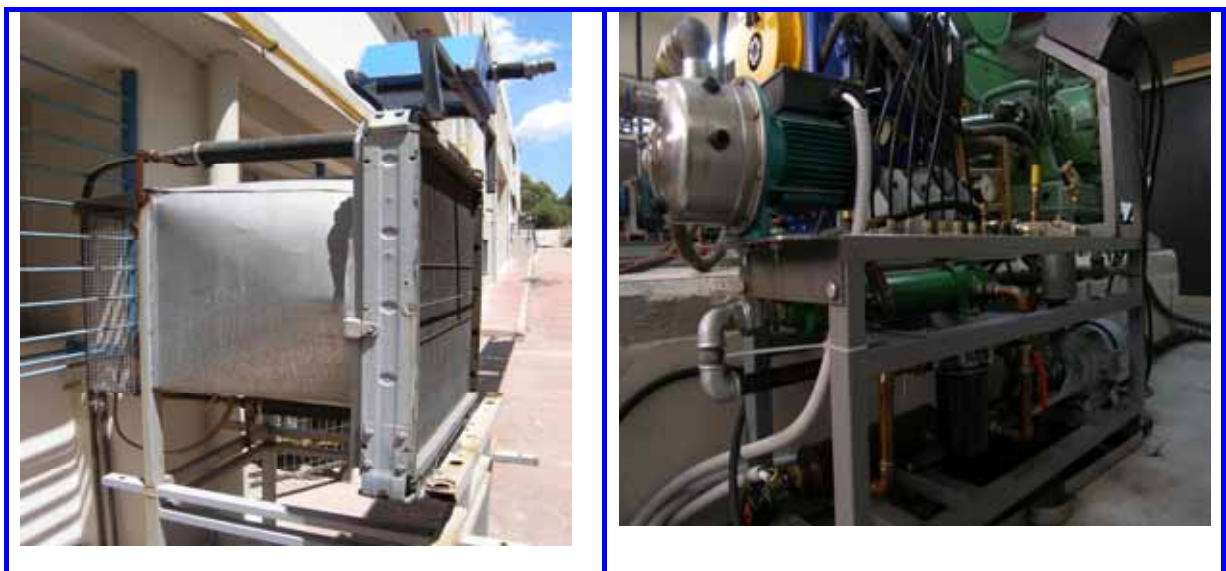
Εικόνα 9.3. Το ψυγείο και η αντλία του κλειστού κυκλώματος ψύξης.
