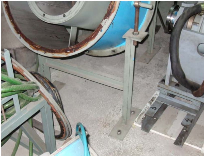
Σχήμα 5.10: Πλαισιωτό στήριγμα αγωγού μαζί με τις ντίζες για τη στήριξη του αγωγού μέσω των κυλινδρικών του νεύρων. Είναι χαρακτηριστικό ότι η κάθε ντίζα έχει δύο περικόχλια για τη συγκράτησή της. Μέσω της κάθε ντίζας και του σπειρώματος που φέρει γίνεται δυνατή η ρύθμιση του ύψους του αγωγού.
