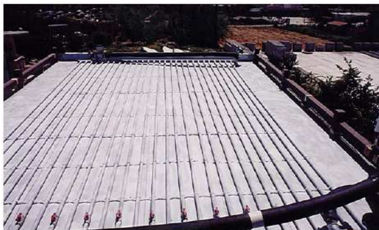
Εικόνα 5: Ψυκτικό πάνελ νερού εγκατεστημένο σε οροφή πρωτοτύπου στο ΚΑΠΕ . [23]
