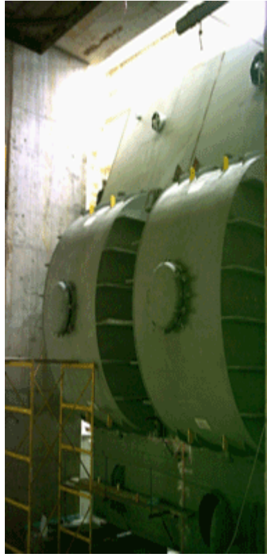
Σχήμα 2.3: Επιφανειακός συμπυκνωτής στη μονάδα 5 του Λαυρίου [13]
