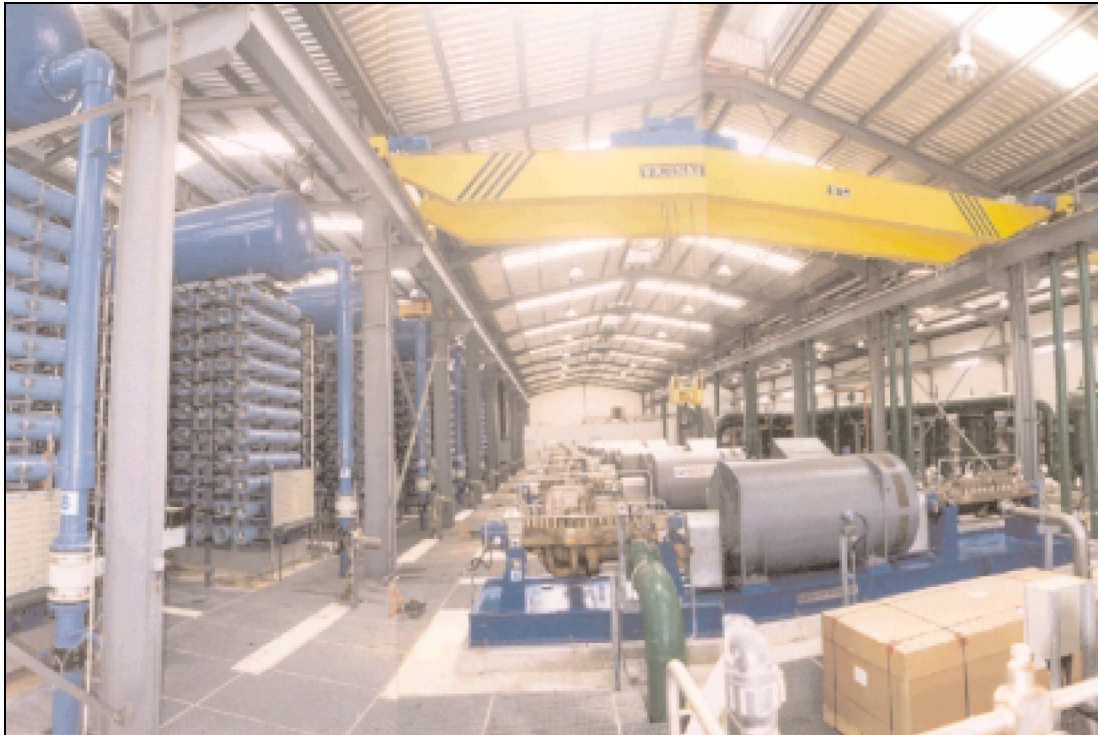
Εγκατάσταση αντίστροφης όσμωσης (Δεκέλεια Κύπρου, δυναμικότητα 40.000 m 3 /ημέρα)
