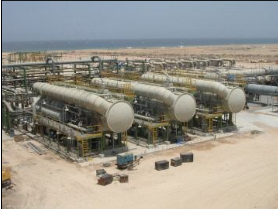
Εγκατάσταση πολυβάθμιας εξάτμισης στο Ομάν (3 x 2400 m 3 /ημέρα)
