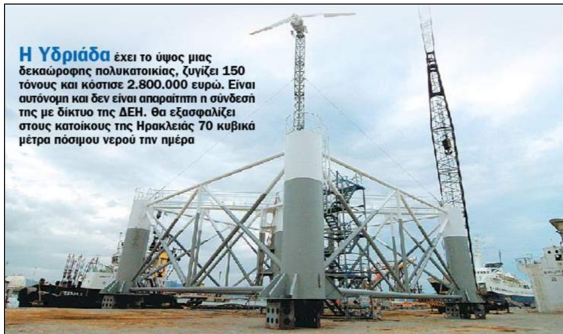
Η «Υδριάδα», η πρώτη παγκοσμίως πλωτή μονάδα αφαλάτωσης
