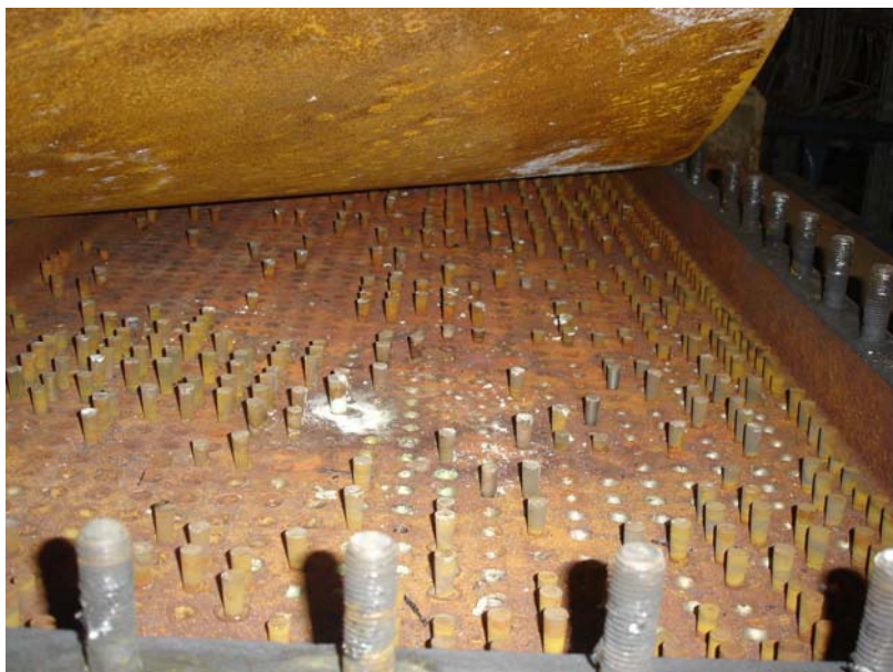
Φώτο 3.17: Κλειστές εισοδοι του νερού λόγω διαρροής
