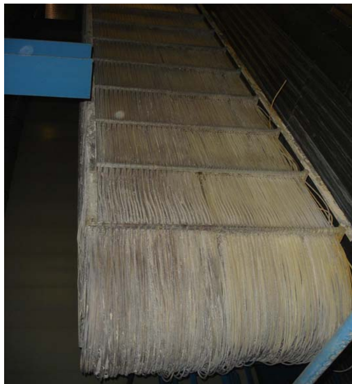
Σχ. 15: Μία από τις 14 δεσμίδες που ήταν εγκατεστημένες ανά Μονάδα στον Ψυκτήρα Καυσαερίων
