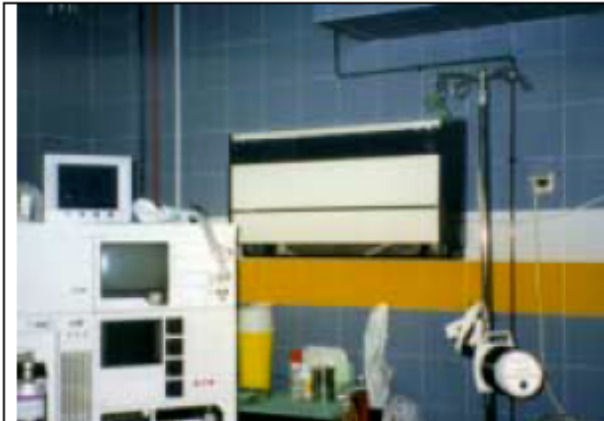
κλιματιστική μονάδα εντός του χειρουργείου
