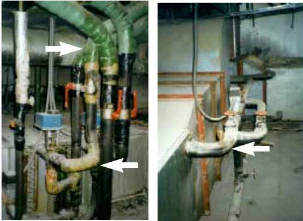
Εικόνα Α.4.5-β: Σωλήνες που συνδέονται με την ΑΗΥ και βρίσκονται σε άσχημη κατάσταση
