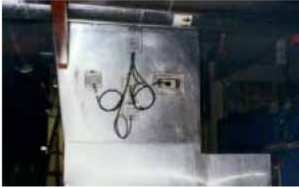
Εικόνα A.4-18: Αισθητήρες θερμοκρασίας και υγρασίας που είναι τοποθετημένοι πάνω στον κύριο αγωγό παροχής αέρα της AHU και μεταβιβάζουν τα δεδομένα στο σύστημα ελέγχου
