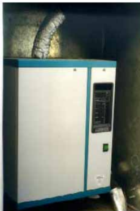
Εικόνα Α.3.2-5: Υγραντήρας ξηρού ατμού
