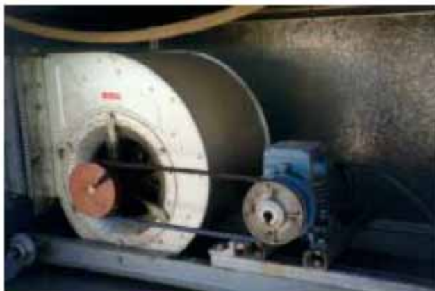
Εικόνα A.4-11: Τυπικοί ανεμιστήρες μιας AHU
