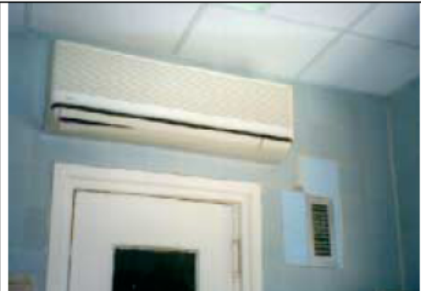
κλιματιστική μονάδα εντός του χειρουργείου
