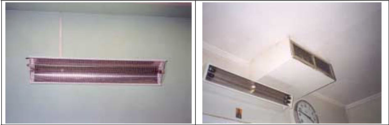
Εικόνα Α.4-6: Εξοπλισμός αποστείρωσης με υπεριώδη ακτινοβολία
