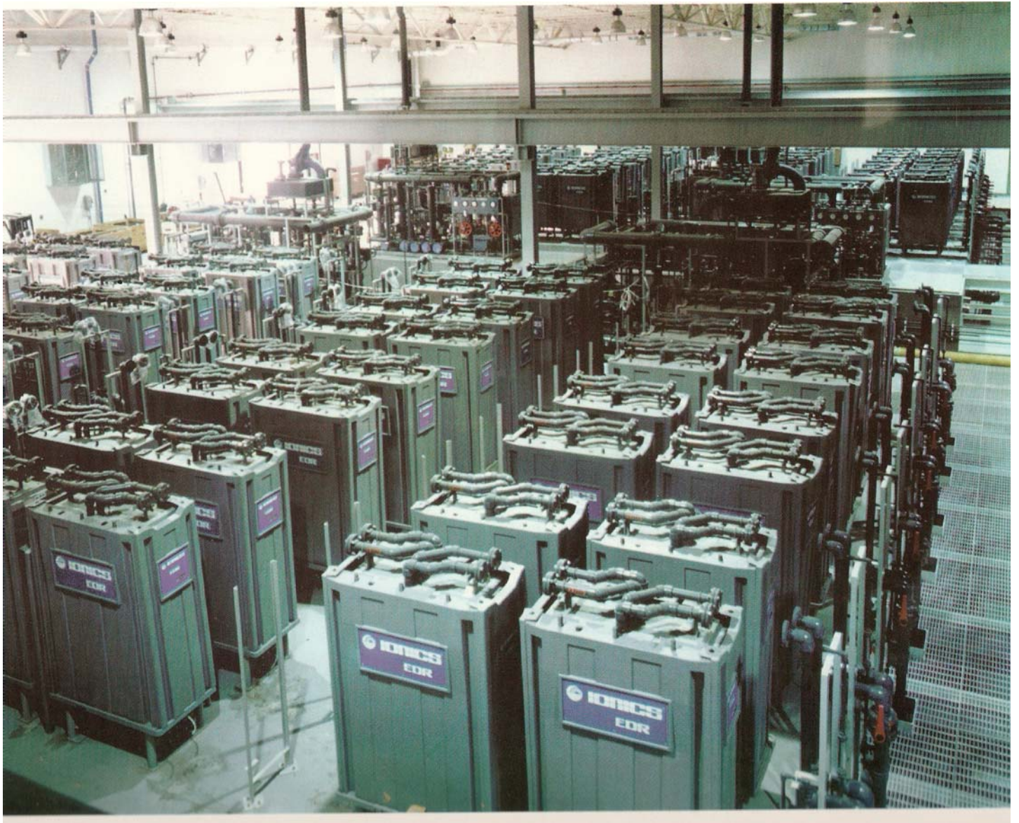
Σχήμα 7.11 Εγκατάσταση αφαλάτωσης με ανάστροφη ηλεκτροδιάλυση στην Σαρασότα της Φλώριδας, U.S.A. Αποτελείται από 10 μονάδες χωρητικότητας 45420\text{m}^3/\text{day} . Στην φωτογραφία φαίνονται μόνο οι 4 μονάδες της εγκατάστασης.
