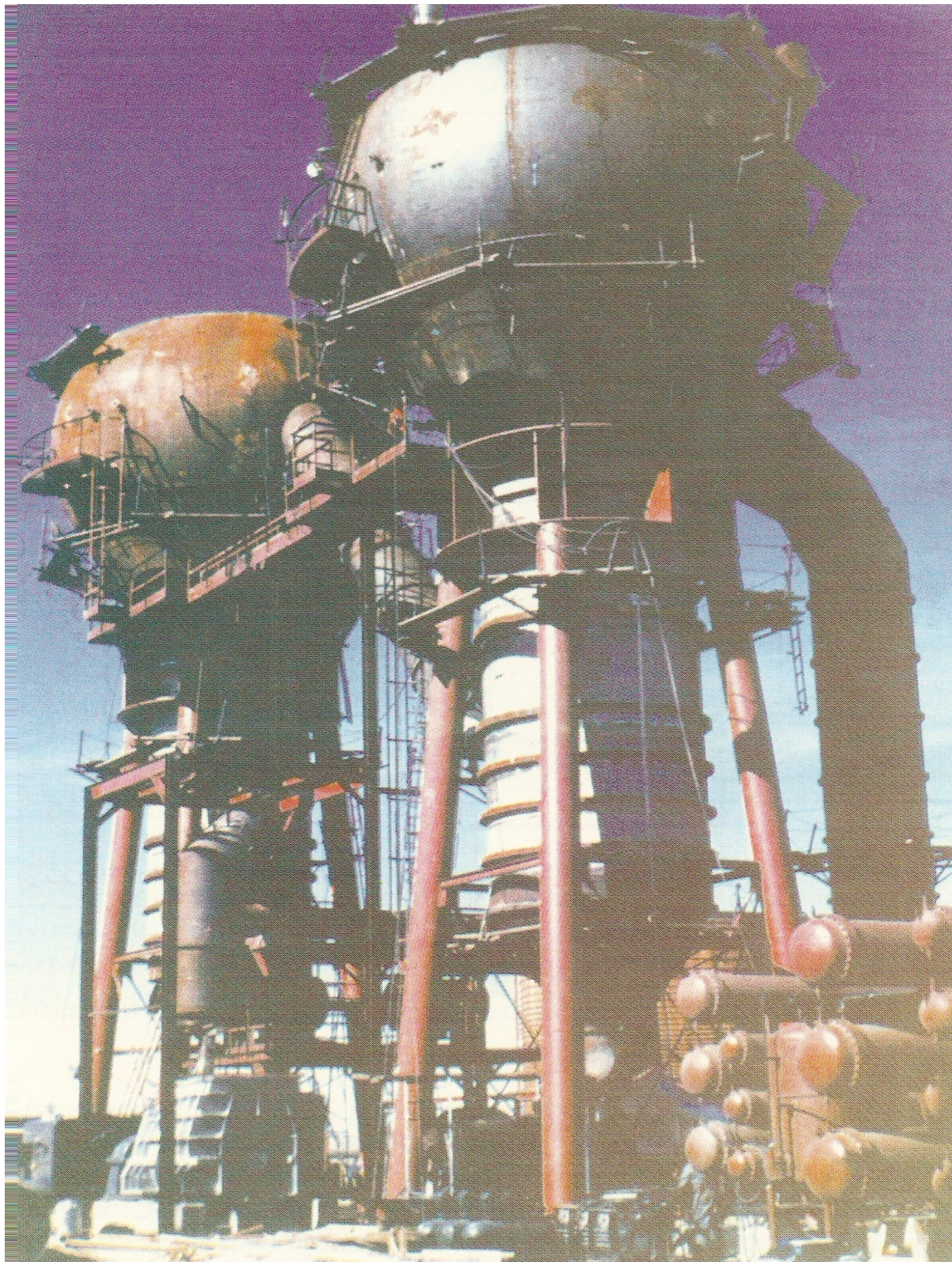
Σχήμα 7.12 Η εγκατάσταση του OSW, στο Roswell του Νέου Μεξικού με την μέθοδο της μηχανικής επανασυμπίεσης των ατμών.Υπήρξε η μοναδική μεγάλης χωρητικότητας εγκατάσταση στον κόσμο, παροχής 3785\text{m}^3/\text{day} .
