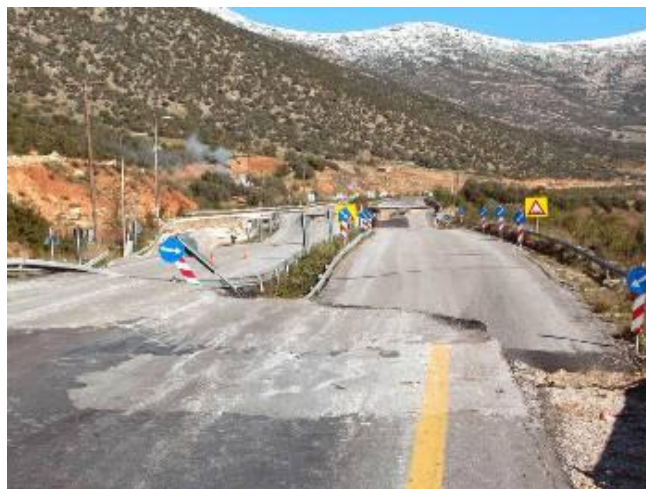
Εικόνα 3.4: Καταστροφή οδικού δικτύου από κατολίσθηση στη Νεμέα Κορινθίας (Eurokinissi, 2003).
