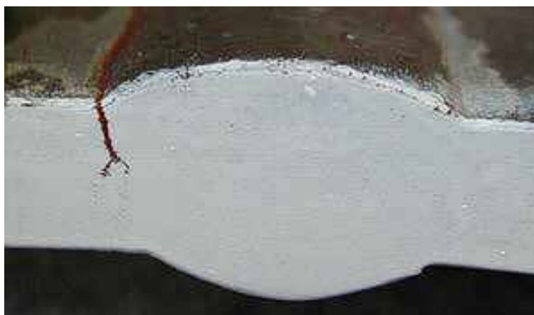
Διάβρωση με μηχανική καταπόνηση
