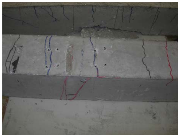
Σχήμα 2.16 Η ρηγμάτωση της κάτω πλευράς της δοκού μετά την αστοχία.
