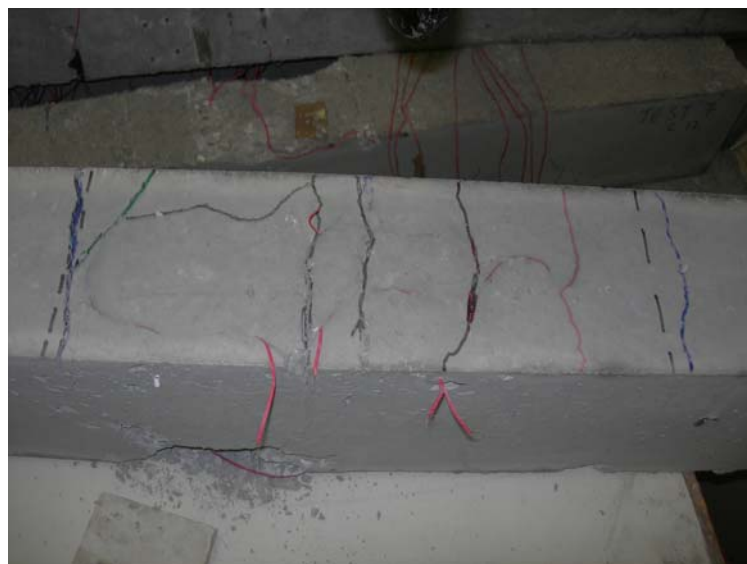
Σχήμα 2.9. Η ρηγμάτωση της κάτω πλευράς της δοκού μετά την αστοχία
