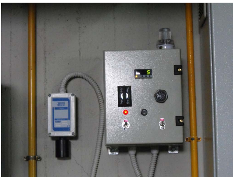
Εικόνα Α.8. Το σύστημα ανίχνευσης του CO. Ο αριστερός διακόπτης ανοίγει το σύστημα. Ο δεξιός ενεργοποιεί τον ηχητικό συναγερμό.
