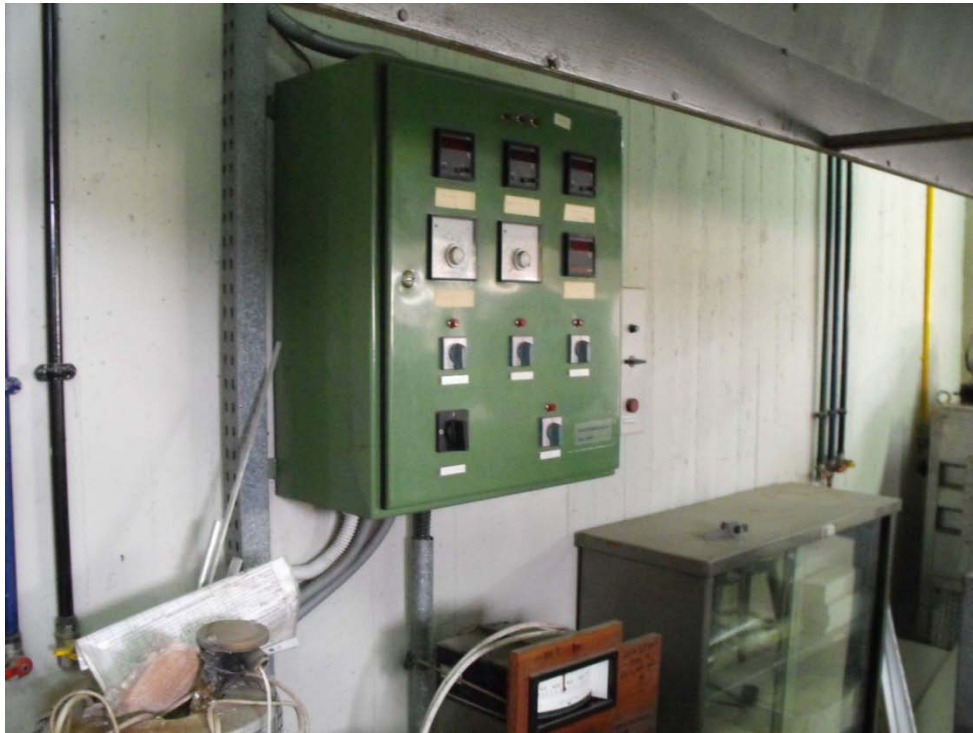
Εικόνα Α.3. Το κεντρικός πίνακας ρευματοδότησης του καμινιού. Ο διακόπτης βρίσκεται κάτω αριστερά.
