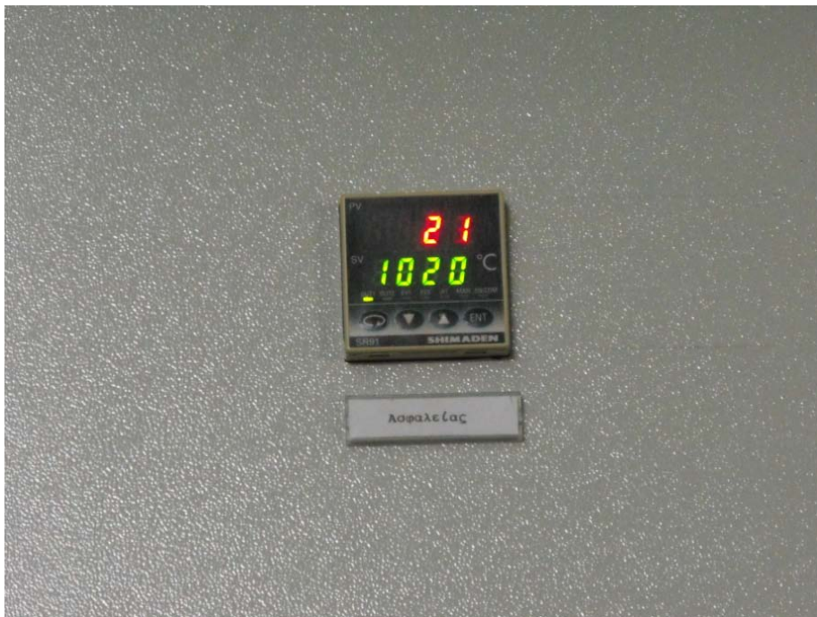
Εικόνα Α.6. Ρύθμιση της θερμοκρασίας ασφαλείας.
