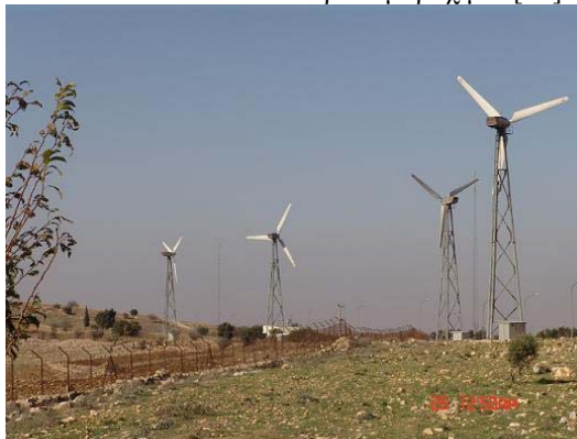
Εικόνα 3.4-5 Αιολικό πάρκο Ιμπραχίμια [17]
