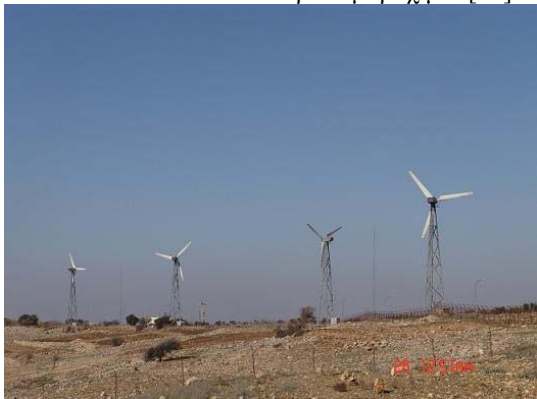
Εικόνα 3.4-4 Αιολικό πάρκο Ιμπραχίμια [17]
