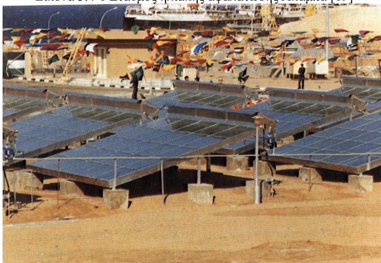
Εικόνα 3.4-1 Σταθμός ηλιακής αφαλάτωσης Άκαμπα [19]
