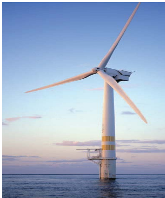
Εικόνα 2.5 Υπεράκτια αιολική εγκατάσταση (EWEA, 2007)
