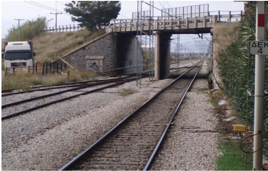
Εικόνα 3.1: Κάτω Διάβαση της Δεκέλειας
