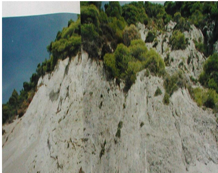
Εικόνα 5.14: Άποψη των ισχυρών επιδερμικών θραύσεων στην περιοχή (Χ.Θ 1+100 έως Χ.Θ. 1+200). Διακρίνονται το ανάντη βραχώδες και φυτοκαλυμμένο φυσικό έδαφος.
