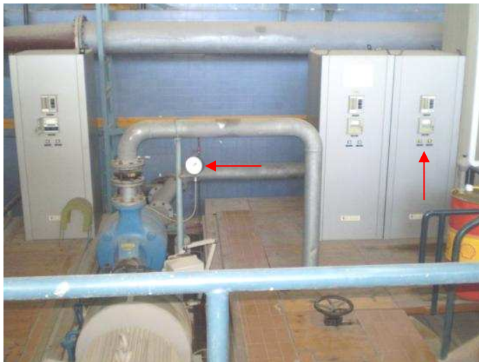
Εικόνα 3.7 Πολυβάθμια φυγοκεντρική αντλία. Στο κέντρο φαίνεται το μηχανικό μανόμετρο ένδειξης της πίεσης της αντλίας, δεξιά οι πίνακες ελέγχου του συστήματος του μέτρησης της παροχής και οι ενδεικτικές λυχνίες αλλαγής της περιοχής λειτουργίας του.
