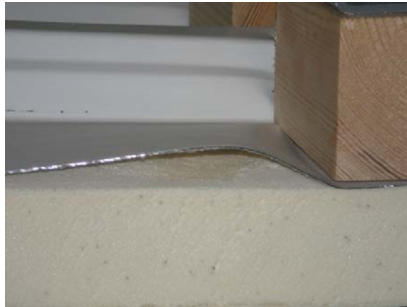
Σχήμα 5.51: Αστοχία δοκιμίου τραπεζοειδούς πάνελ ,με D= 50\text{mm} και L_p=3000\text{ mm} , που καταπονήθηκε σε κάμψη έξι σημείων. Είναι εμφανής η διάτμηση του πυρήνα ,οι πτυχώσεις (κυματώσεις) , που έχουν δημιουργηθεί στο άνω φύλλο χάλυβα καθώς και η αποκόλληση της άνω επιφάνειας χάλυβα από τον πυρήνα πολυουρεθάνης.
