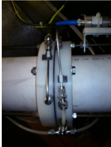
Εικόνα 3-12 Φωτογραφία Διαφράγματος στον αγωγό εισαγωγής ατμ. αέρα στον Κινητήρα.
