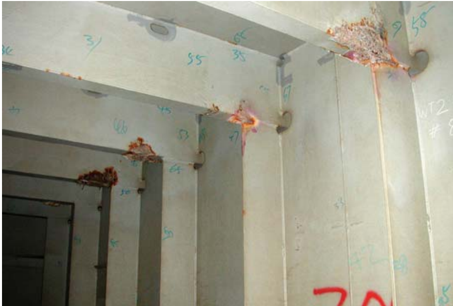
Εικόνα 3.8 – Εμφάνιση τοπικής διάβρωσης σε περιοχές που καταπονούνται από κόπωση [12]
