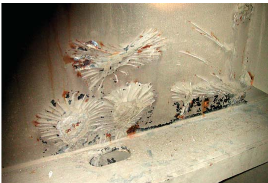
Εικόνα 3.22 – Ανεπαρκής χρόνος στερεοποίησης, πριν την πλύση (επάνω) και αστοχία ψαθυρού επικαλυπτικού λόγω κρούσης από την άλλη πλευρά (κάτω) [12]
