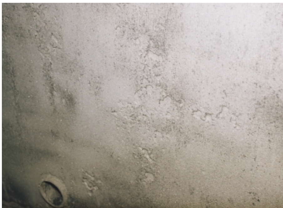
Εικόνα 2.5 - Διάβρωση με βελονισμούς, μεγάλης έκτασης, σε δεξαμενή [26]
