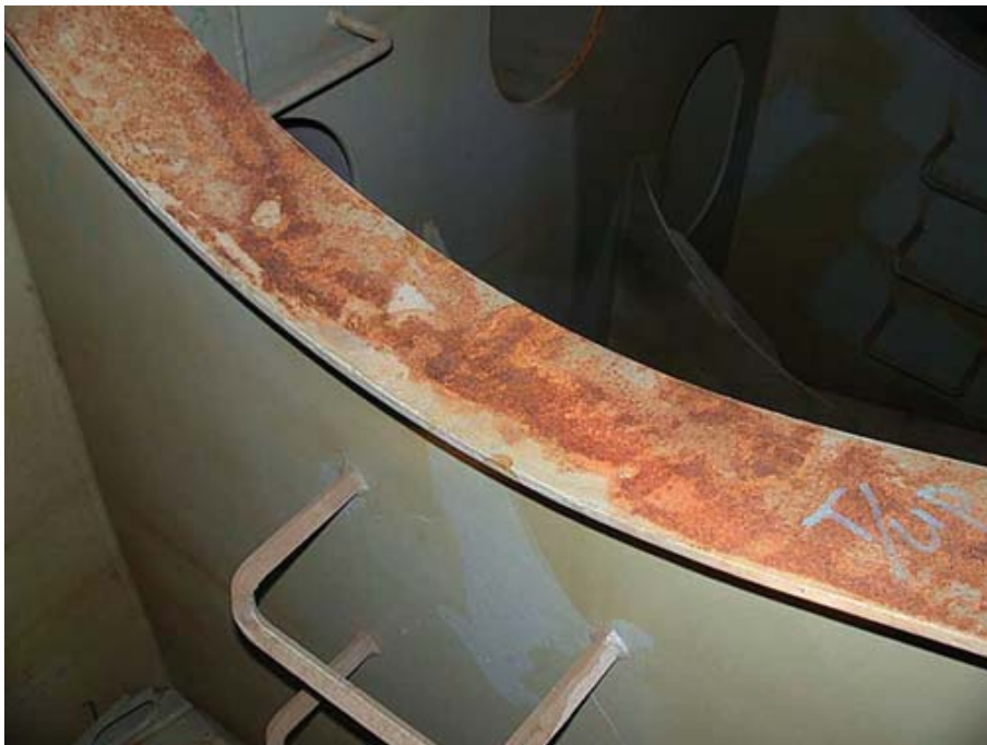
Εικόνα 3.14– Το αποτέλεσμα ελλιπούς πάχους στρώσης στην κατασκευή [26]
