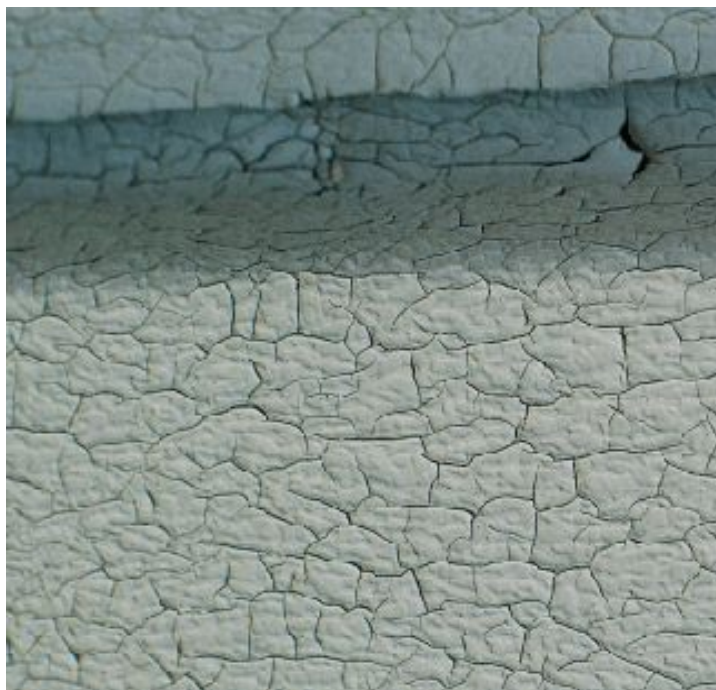
Εικόνα 3.21 – Ρωγμάτωση μορφής «ξηραμένης λάσπης» [26]
