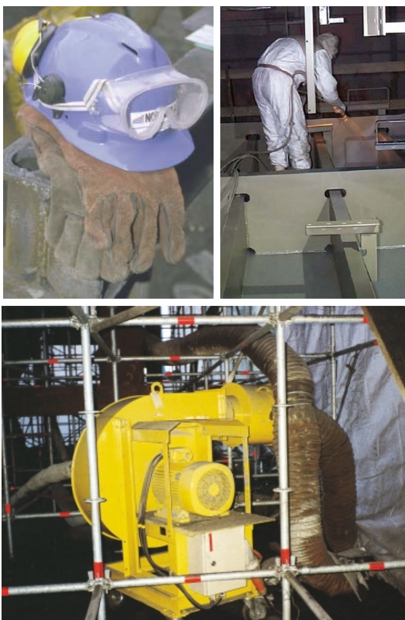
Εικόνα 6.3 - Η τήρηση των κανονισμών ασφαλείας είναι ζωτικής σημασίας, από τα πιο απλά μέσα ατομικής προστασίας (πάνω αριστερά), μέχρι το σωστό εξαερισμό των δεξαμενών (κάτω) [21], [26]
