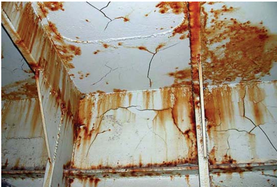
Εικόνα 3.9 – Ρωγμάτωση επικαλυπτικού, από συνδυασμό υψηλού πάχους στρώσης και απώλειας διαλύτη, εσωτερικά της οροφής δεξαμενής έρματος [12]
