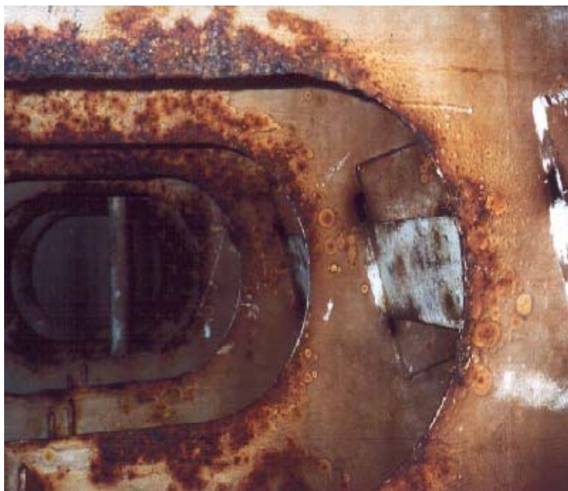
Εικόνα 2.2 - Γενική διάβρωση σε δεξαμενή έρματος [39]
