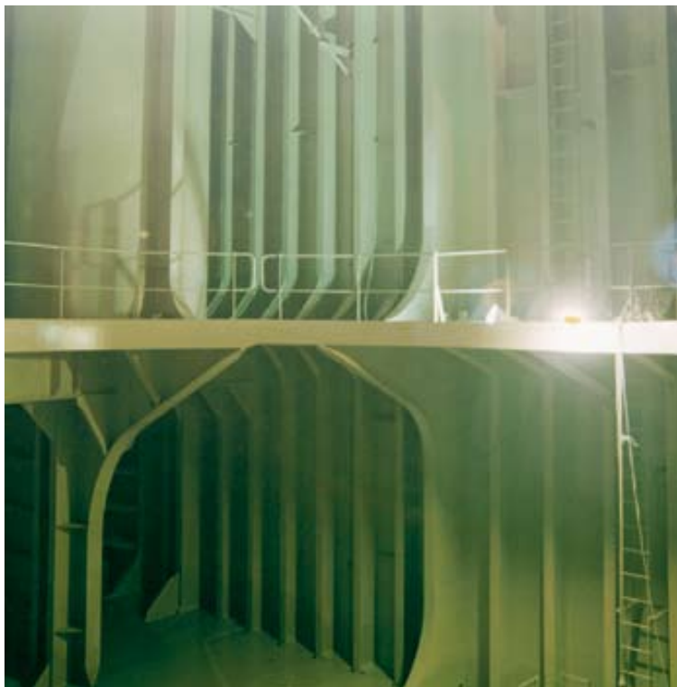
Εικόνα 6.7 - Η πολυπλοκότητα της πρωραίας δεξαμενής ζυγοστάθμισης δυσχεραίνει το έργο των συνεργείων βαφής [51]
