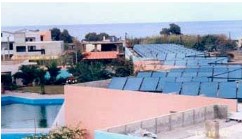
ΕΙΚΟΝΑ 4.3: Ηλιακοί συλλέκτες στην οροφή του κτιρίου για τη θέρμανση χώρου
