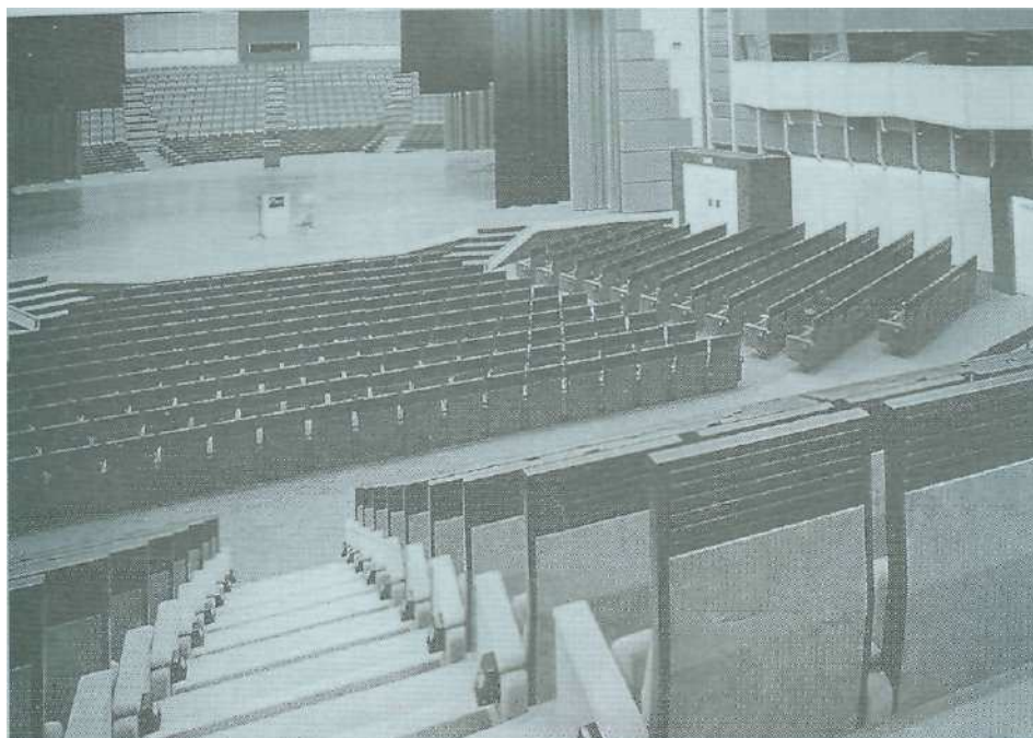
Εικ. 2.4 - Πολυθρόνες με παροχή του αέρα από την πλάτη σε μία θεατρική αίθουσα. Η γρίλια διάχυσης εφαρμόζεται στο πίσω μέρος της πολυθρόνας. Η τροφοδοσία του πρωτεύοντα αέρα γίνεται από κάτω, μέσα από το θάλαμο συγκέντρωσης κάτω από το δάπεδο.
