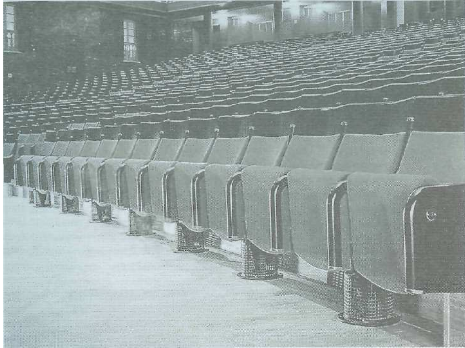
Εικ. 2.3 - Στόμια αερισμού ποδιού πολυθρόνας εγκατεστημένα σε ένα θέατρο. Κάθε στόμιο είναι εγκατεστημένο ανάμεσα σε δύο πολυθρόνες. Η τροφοδοσία αέρα γίνεται, όπως στην προηγούμενη περίπτωση, από ένα θάλαμο συγκέντρωσης που έχει δημιουργηθεί κάτω από το δάπεδο.
