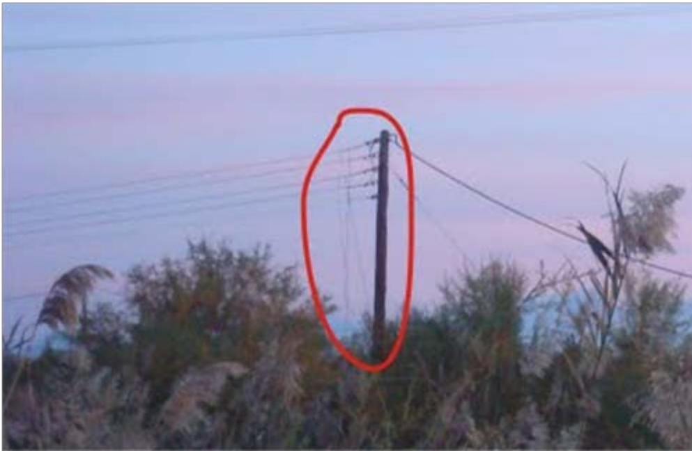
Εικόνα 4-14: Παράνομη σύνδεση με δίκτυο ΔΕΗ που εξυπηρετεί χώρο διαμονής Ρομά στο Αιτωλικό Μεσολογγίου (Πηγή: etolikomep.blogspot.com )
