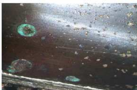
Φωτογραφία8.2-βελονισμοί(φαίνονται με πράσινο χρώμα) στην επιφάνεια του σωλήνα που αστόχησε
