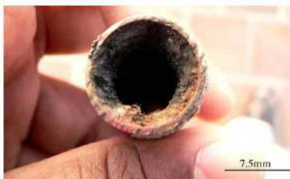
Φωτογραφία8.1-Λασπώδης μεμβράνη στην εσωτερική επιφάνεια του σωλήνα που αστόχησε
