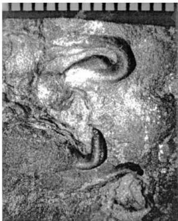
Φωτογραφία 8.20-δημιουργία κρατήρων στην επιφάνεια του σωλήνα λόγω μηχανικής διάβρωσης
