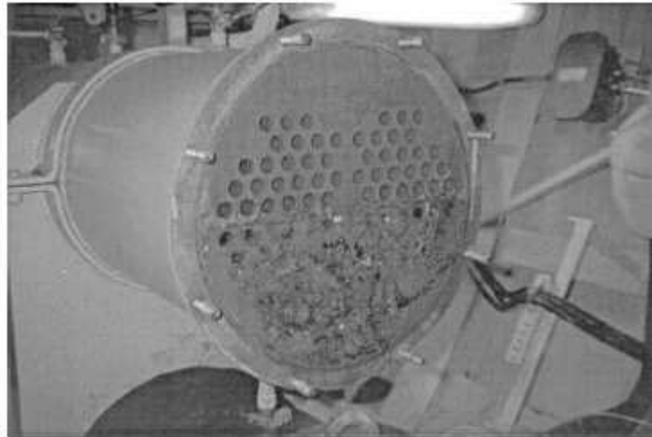
Φωτογραφία 8.23-έκταση του μπλοκαρίσματος του σωλήνα λόγω "νεκρών" θαλάσσιων οργανισμών
