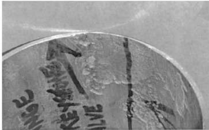
Φωτογραφία 8.21-σημάδια μηχανικής διάβρωσης κοντά σε βαλβίδα σωλήνα πυροσβεστικού συστήματος
