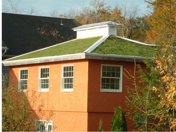
Εικόνα 37 Πράσινη στέγη (Centre for Discovery Gatehouse, Harris, NY) με ετήσιο κόστος συντήρησης 300$
