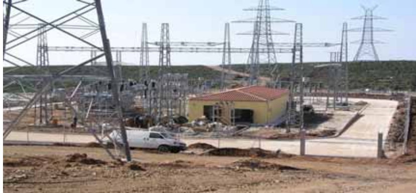
Εικόνα 14: Τυπικός υποσταθμός Υ.Τ. 50.000 KVA, 150/21 kV
