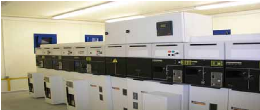
Εικόνα 13: Τυπικός υποσταθμός Μ.Τ. 0,4/15 kV
