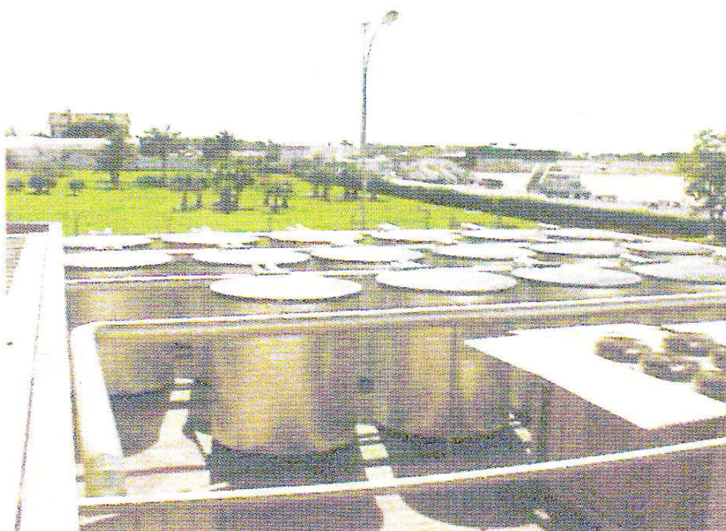
Σχήμα 3. Άποψη από τη μονάδα παραγωγής ψυχρού ύδατος και από τις παγολεκάνες
