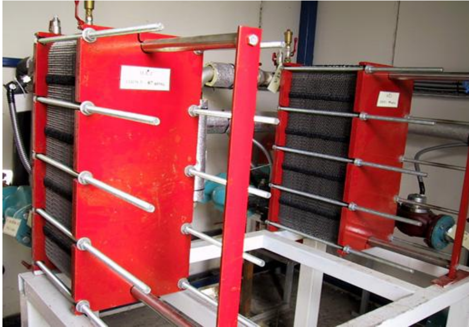
Σχήμα 13 Εναλλάκτες νερού - νερού εγκατεστημένοι σε βιομηχανία.
