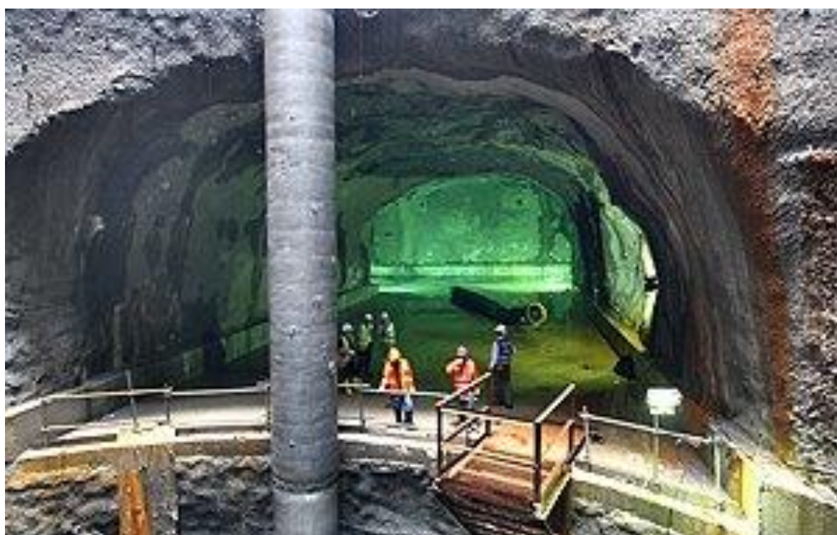
Εικόνα 3.16 Εσωτερικό οριζόντιου θαλάμου (Σιγκαπούρη)
