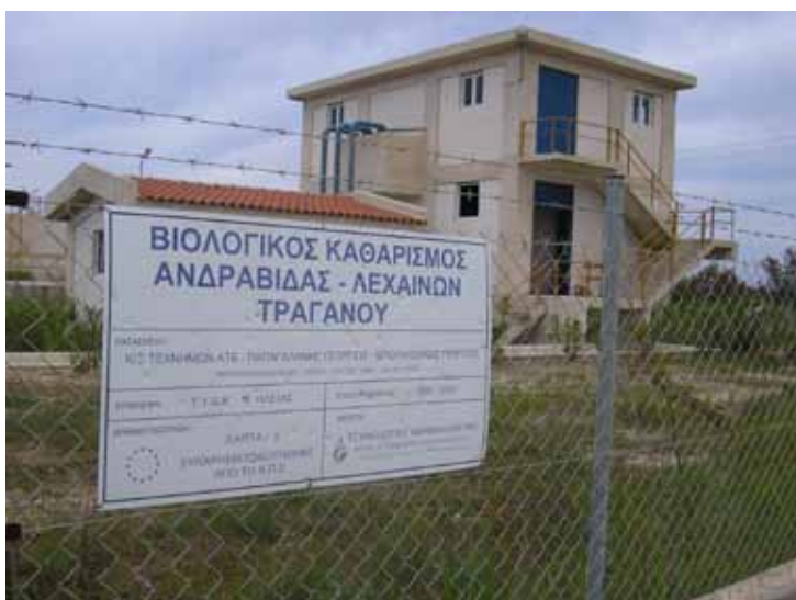
Εικόνα 22: Ο βιολογικός καθαρισμός. Διακρίνεται ανοιχτή πόρτα στο κτίριο. Τα σημάδια στην πινακίδα είναι από σφαίρες.
