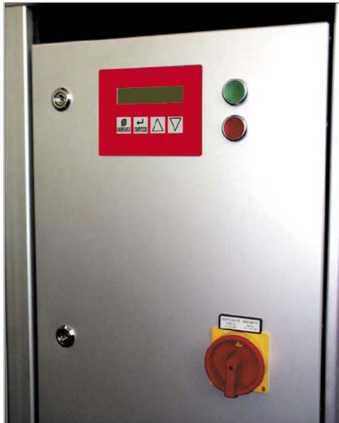
Σχήμα 5.13: Οθόνη ενδείξεων υγρών κρυστάλλων, κομβία εκκίνησης (πράσινο) και τερματισμού (κόκκινο), κεντρικός διακόπτης.
