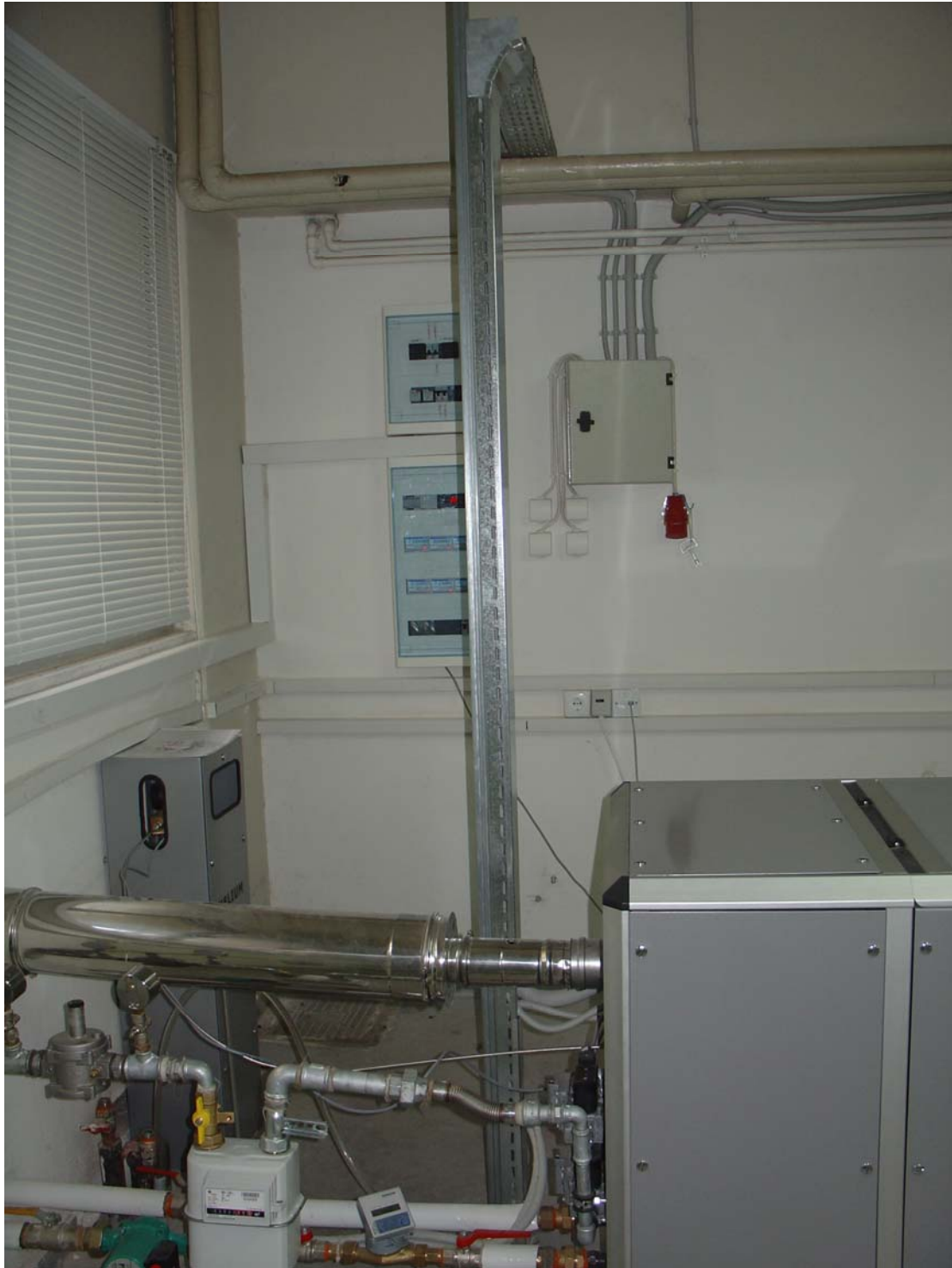
Σχήμα 6.9: Εγκατάσταση τροφοδοσίας και παροχής ηλεκτρικής ενέργειας (Σχολή Μηχανολόγων Μηχανικών Ε.Μ.Π. – Εργαστήριο Εφαρμοσμένης Θερμοδυναμικής)
