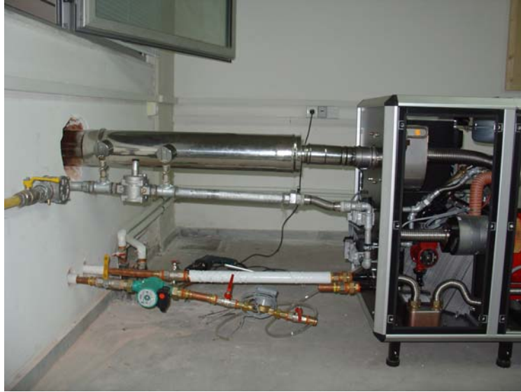
Σχήμα 5.18: Ο εναλλάκτης θερμότητας των καυσαερίων όπως φαίνεται όταν αφαιρέσουμε το πλαινό κάλυμα του πλαισίου. (Εικόνα κατά τη διάρκεια της εγκατάστασης της Solo Stirling V161 στο χώρο του εργαστηρίου Εφηρμοσμένης Θερμοδυναμικής του Ε.Μ.Π.)
