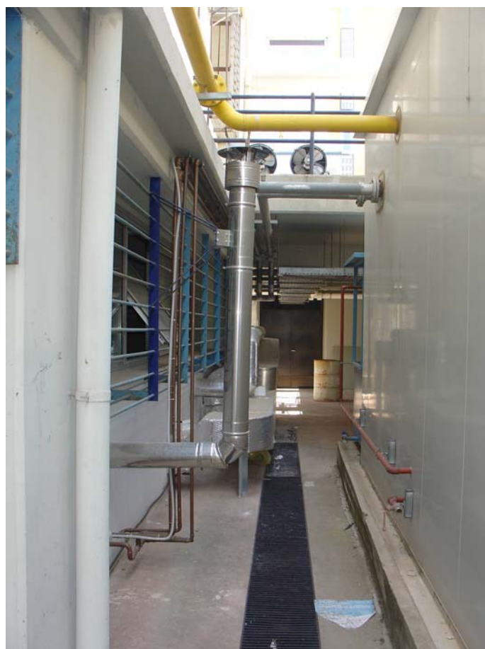
Σχήμα 6.8: Δίκτυο σωληνώσεων εξωτερικού κυκλώματος ψύξης (Σχολή Μηχανολόγων Μηχανικών Ε.Μ.Π. – Εργαστήριο Εφαρμοσμένης Θερμοδυναμικής)
