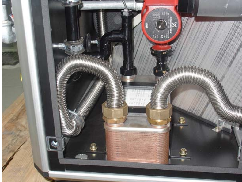
Σχήμα 5.15: Πλακοειδής εναλλάκτης συναλλαγής θερμότητας μεταξύ του εσωτερικού και του εξωτερικού κυκλώματος νερού. Διακρίνεται και η αντλία του ψυκτικού υγρού του εσωτερικού κυκλώματος ψύξης της μηχανής.
