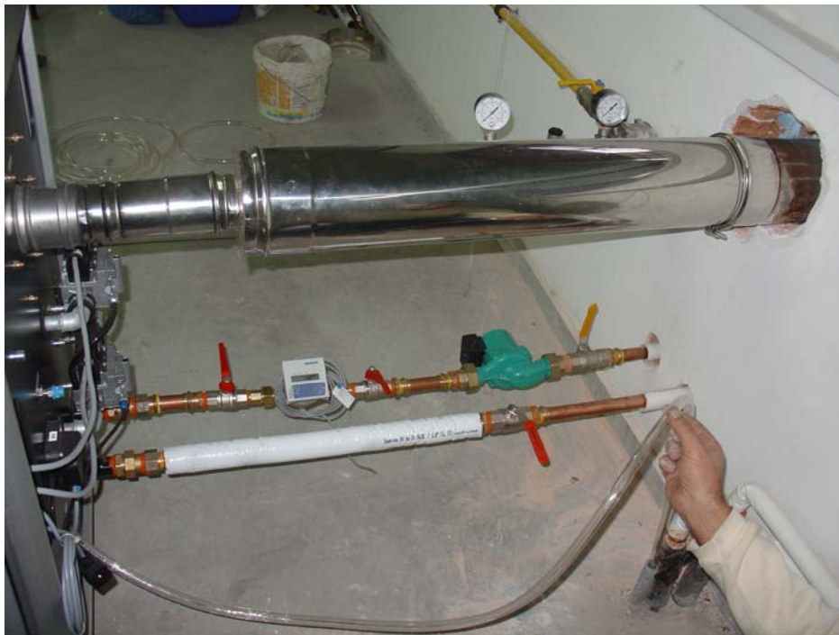
Σχήμα 5.16: Απεικόνιση της καπνοδόχου και του εξωτερικού κυκλώματος νερού, όπου διακρίνονται η εξωτερική αντλία και το παροχόμετρο. Επίσης φαίνεται και ο διαφανής αγωγός απορροής των συμπυκνωμάτων από τον εναλλάκτη των καυσαερίων. (Εικόνα κατά τη διάρκεια της εγκατάστασης της Solo Stirling V161 στο χώρο του εργαστηρίου Εφηρμοσμένης Θερμοδυναμικής του Ε.Μ.Π.)
