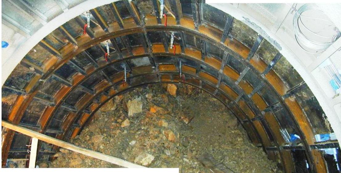
Εικόνα 2.2: Αστοχία μετώπου εκσκαφής σήραγγας εκτροπής φράγματος Αγιονερίου Ν. Λάρισας.
