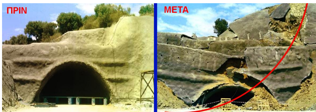
Εικόνα 2.1: Αστοχία του νοτίου στομίου της οδικής σήραγγας παράκαμψης της Πάτρας (Καββαδάς, 2007)
