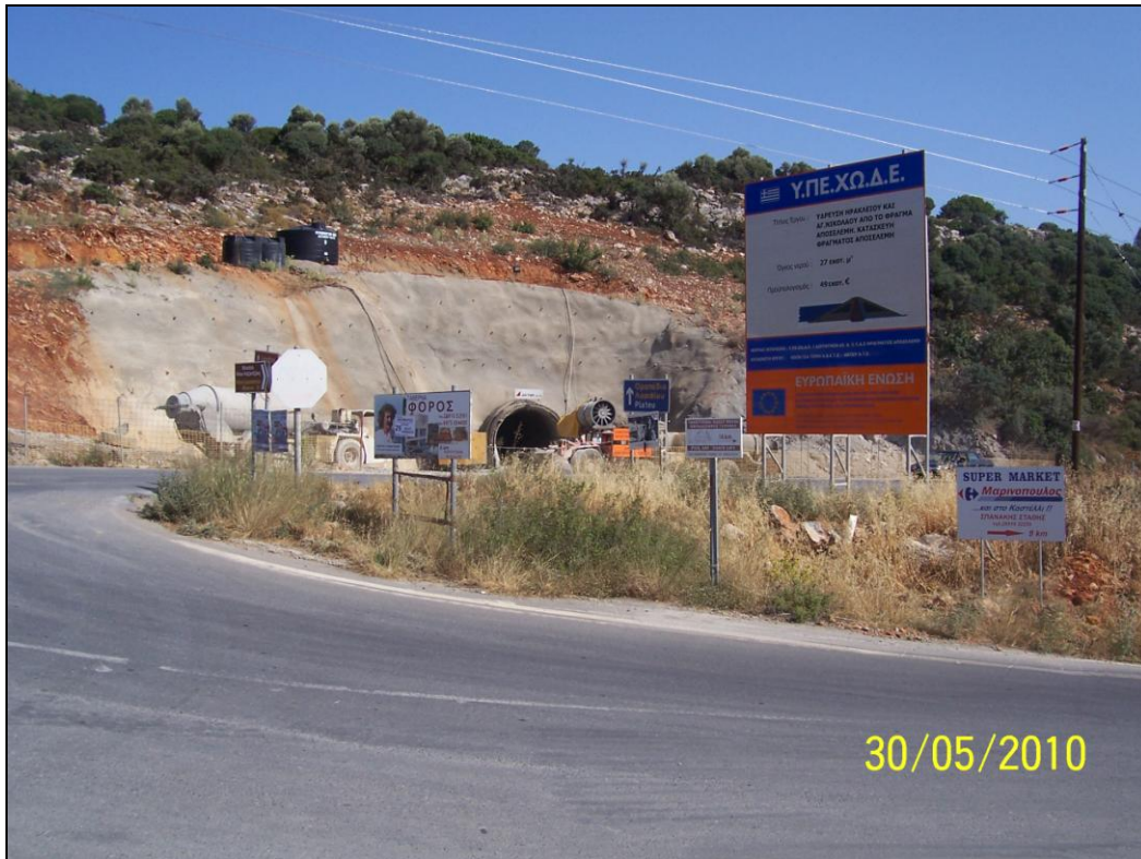
Φωτογραφία 7 : Έξοδος αγωγού μεταφοράς υδάτων Φράγματος προς διωλιστήριο
