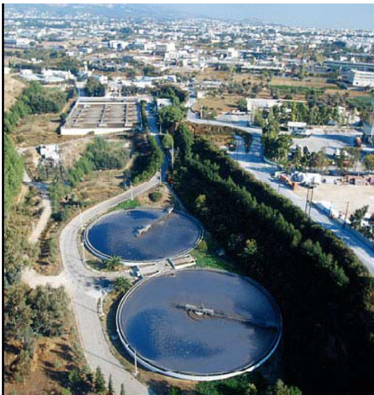
Εικόνα 2.5: Δεξαμενές τελικής καθίζησης
