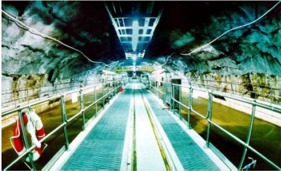
Εικόνα 1.49: Υπόγειος θάλαμος κύριας επεξεργασίας λυμάτων
