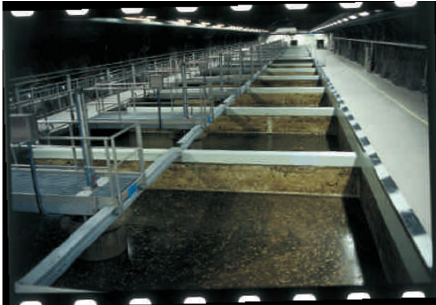
Εικόνα 1.65: Θάλαμος επεξεργασίας του υπόγειου κέντρου επεξεργασίας λυμάτων Henriksdal
