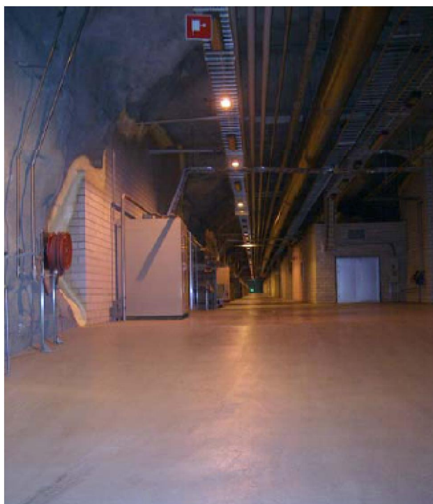
Εικόνα 1.31: Υπόγειος θάλαμος του κέντρου επεξεργασίας λυμάτων
