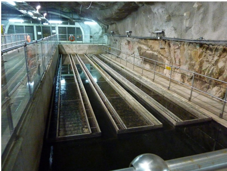
Εικόνα 1.55: Χώρος φίλτρων του κέντρου επεξεργασίας λυμάτων Stanley
