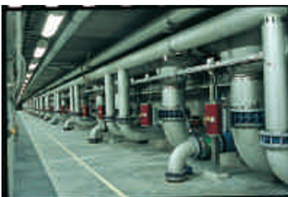
Εικόνα 1.63: Θάλαμος του κέντρου επεξεργασίας λυμάτων Henriksdal
