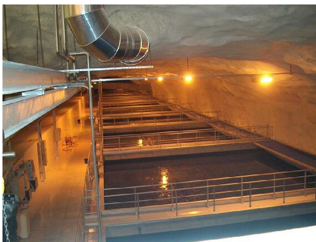
Εικόνα 1.18: Υπόγεια δεξαμενή του κέντρου επεξεργασίας λυμάτων Viikinmäki
