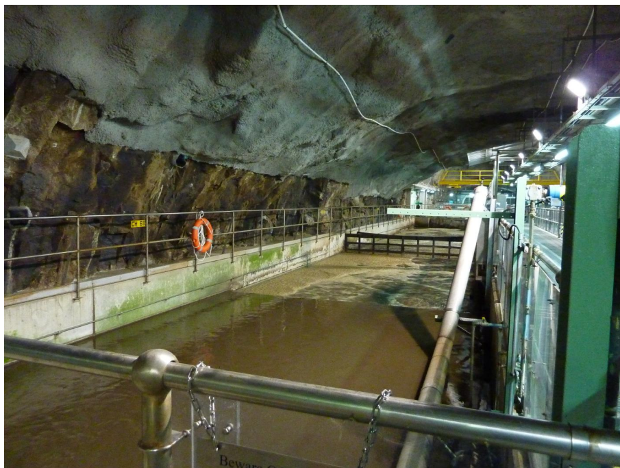
Εικόνα 1.52: Δεξαμενή αερισμού (aeration tank)
