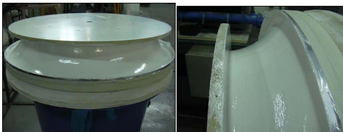
Σχήμα Π4.15: Το καλούπι με τοποθετημένη τη φλάντζα και περασμένο με τα δύο χέρια gelcoat.
