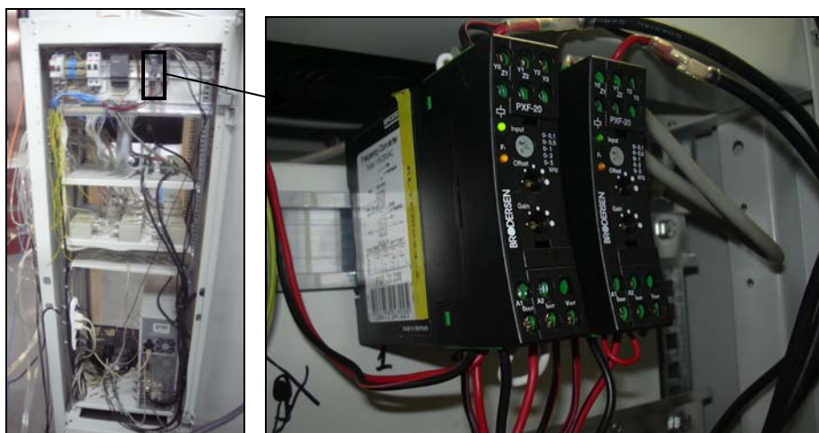
Σχήμα 3.22: Οι μετατροπείς συχνότητας (Frequency Converter) μέσα στην καμπίνα πρόσκτησης και επεξεργασίας σημάτων αισθητήρων.
