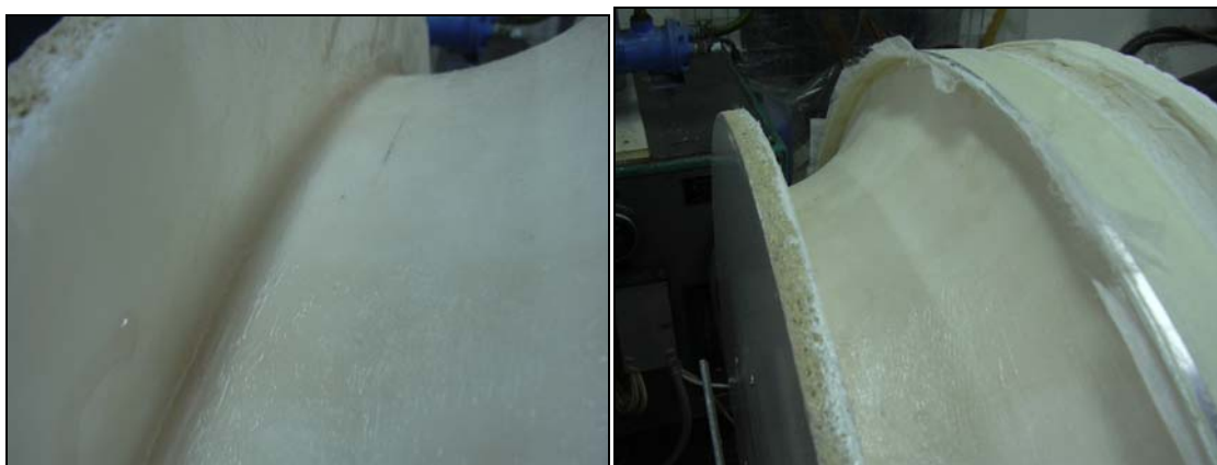
Σχήμα Π4.16: Πρώτη στρώση με ίνες γυαλιού τύπου αράχνη. Σε αυτό το στάδιο διαμορφώσαμε ένα ράδιο στην ακμή της φλάντζας (αριστερά) με πολυεστέρα και πανί.
