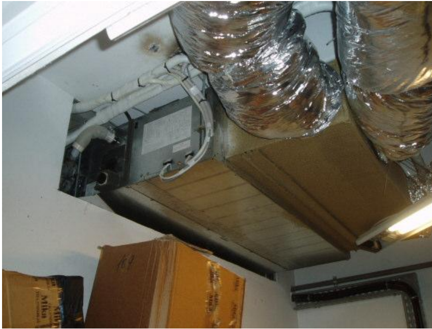
Σχήμα 26-Φωτογραφία των αγωγών αέρα στο υπό μελέτη κτίριο
